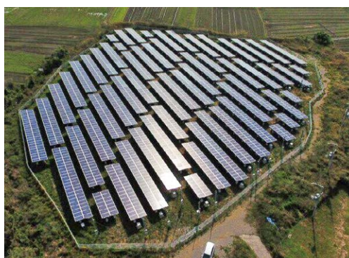
木下第28発電所(和歌山県)
